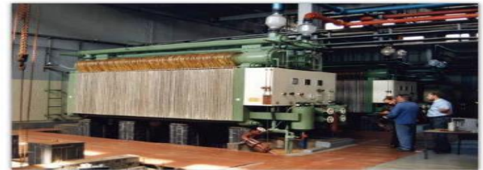
Aswan Electrolyser (KIMA) 165MW - 37000 m 3 H 2 /h
